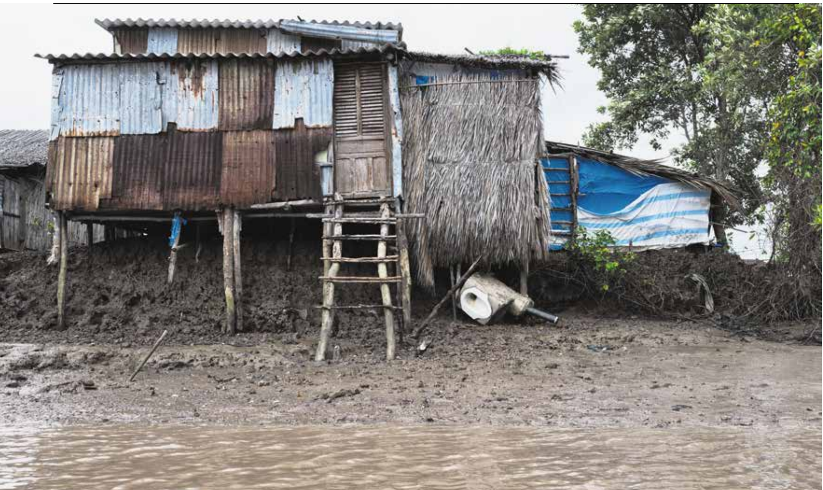
Nur eine Frage der Zeit: Schon heute sind Zehntausende von Wohnhäusern Erosion und Fluten zum Opfer gefallen.
